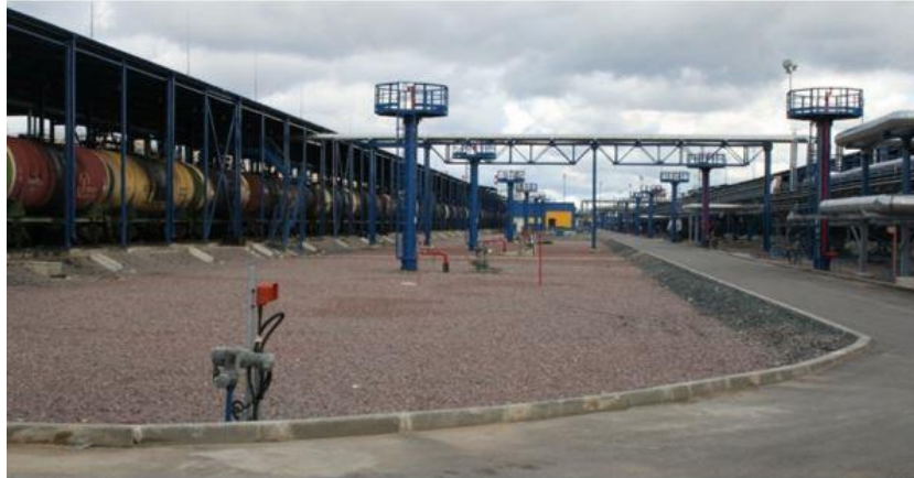
Рис. 5. Сливоналивная железнодорожная эстакада с установленным пожарными вышками
